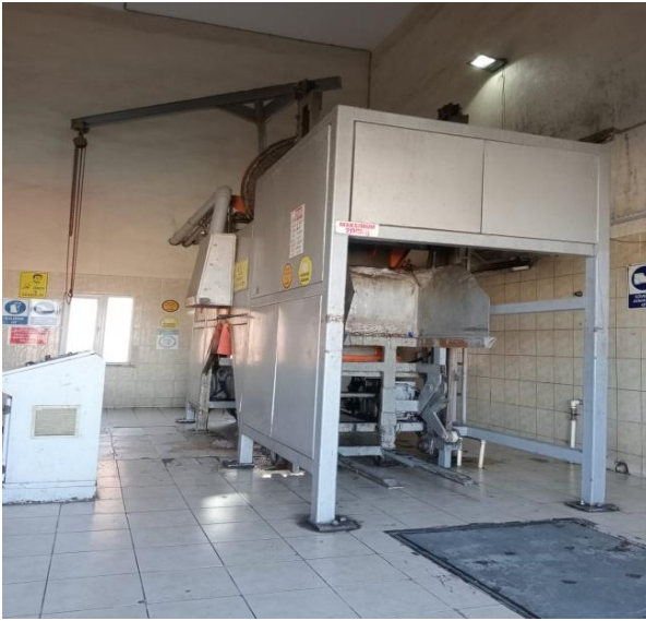
Resim 8. Tıbbi Atık Sterilizasyon Ünitesi
