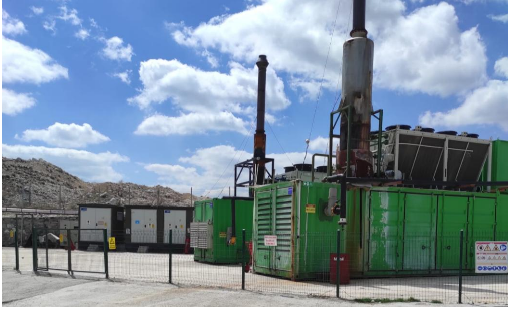
Resim 6. LFG Elektrik Enerjisi Üretim Tesis
