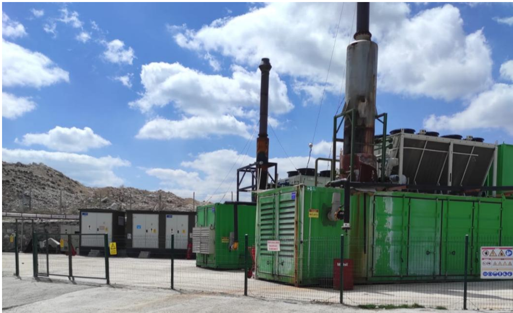
Resim 15. LFG Elektrik Enerjisi Üretim Tesis
